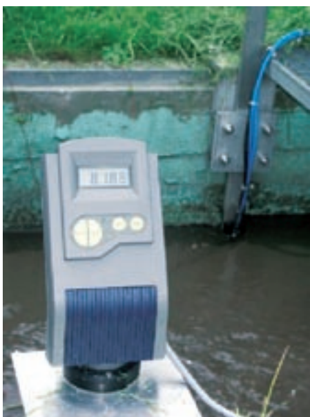
Abbildung 6: Im Vordergrund das Füllstandmesssystem zur Bestimmung der Pegelhöhe, diagonal dahinter (unter Wasser) die an einer Edelstahlschiene montierten Ultraschallsensoren zur Ermittlung der Durchflussmenge.
