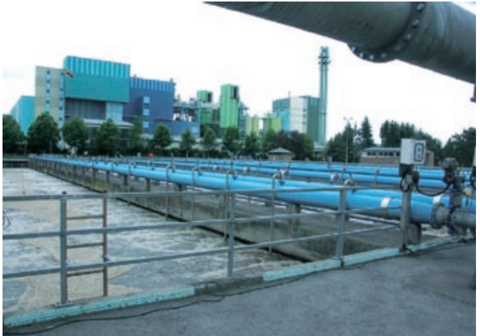
Abbildung 1: Auf der Kläranlage Geiselbullach (Amperverband) wurde das Ultraschall-Multimeter getestet.
